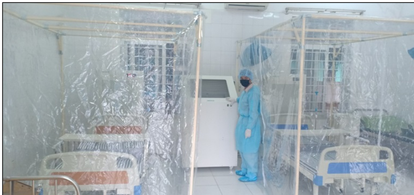
Buồng áp âm được lắp đặt tại Phòng khám đa khoa khu vực Quang Hà. Ảnh: Dương Chung
